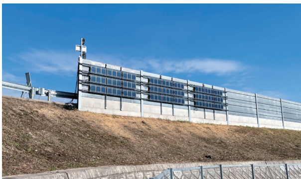
写真-3 PSCの設置状況（道路の遮音壁） ※PSCは愛知県支給（株）アイシン製
